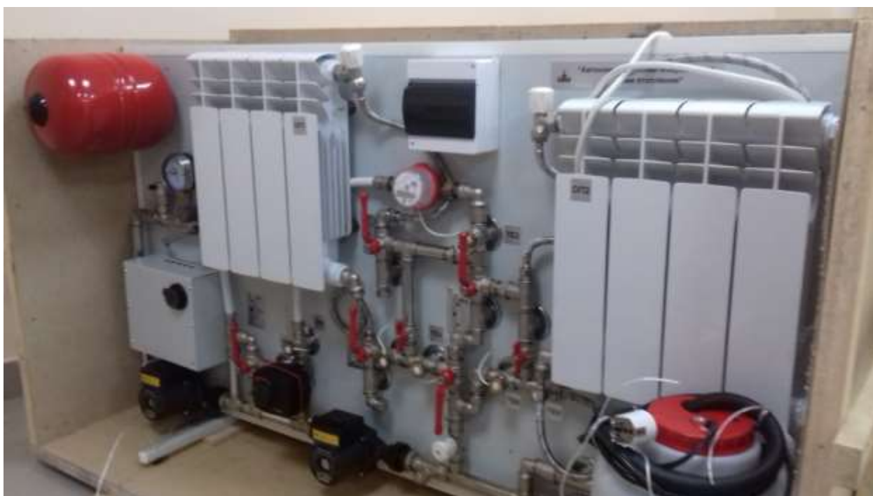
Автономная автоматизированная система отопления
